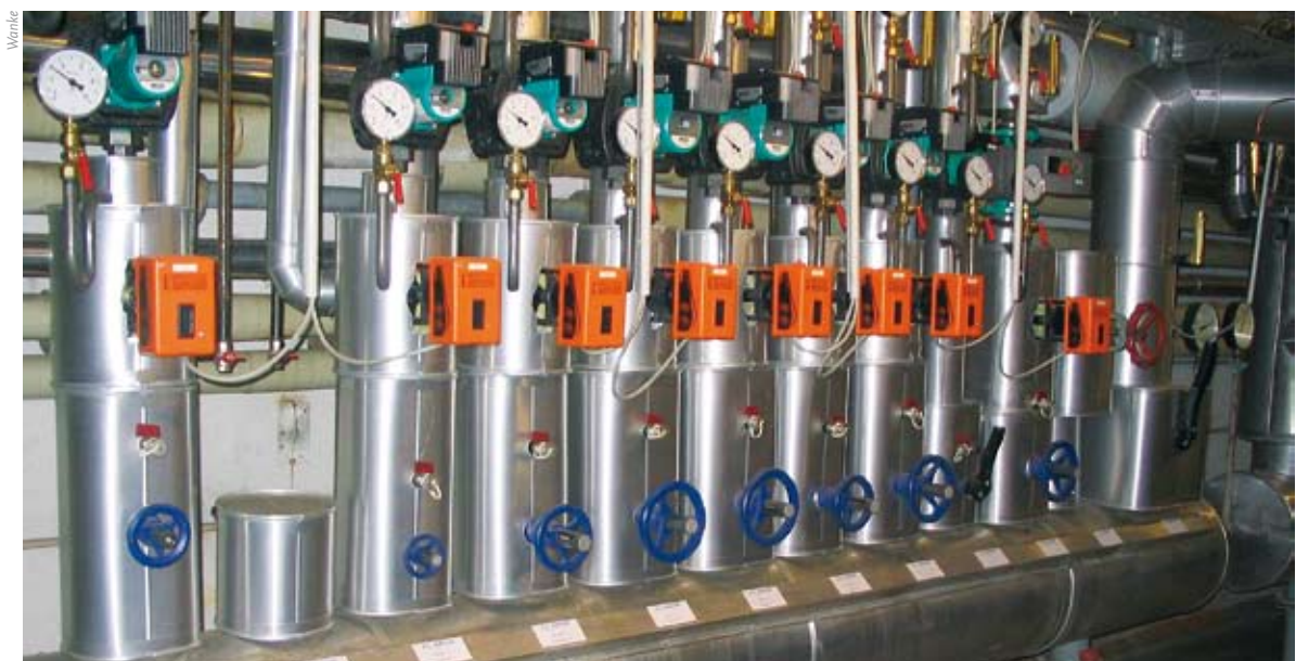
Modernisierte Heizzentrale in der Koserstraße 20. Hier forschen unter anderem Veterinärmediziner und Kunsthistoriker.
