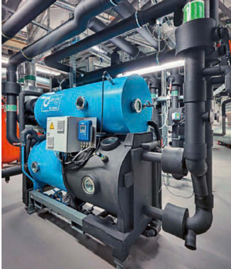
Abb. 25: Neue Absorptionskälteanlage „Prototyp AKA 50 01/2011“
