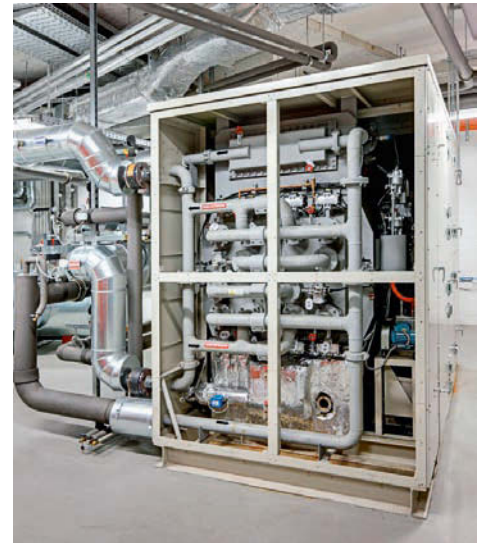
Abb. 24: Ursprüngliche Adsorptionskälteanlage im UBA
