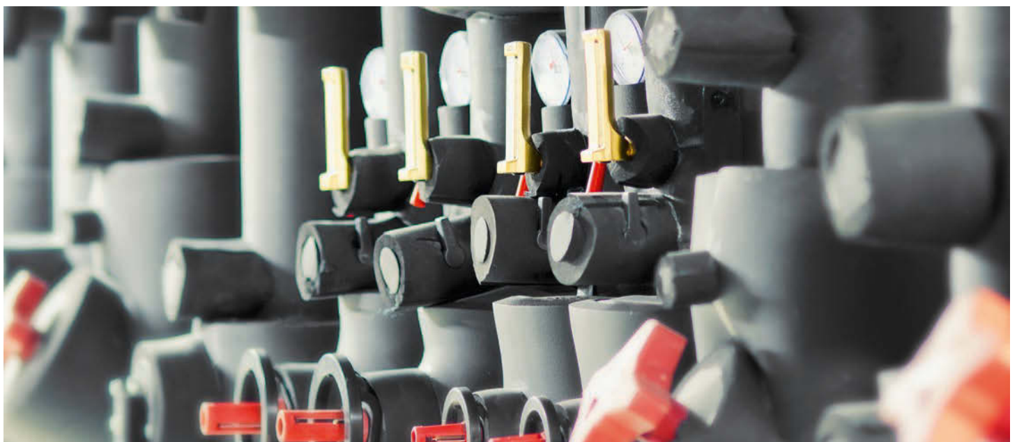
Abb. 21: Kälteanlage der Freien Universität Berlin
